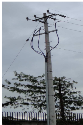
Figura 2.14 Poste de arranque
