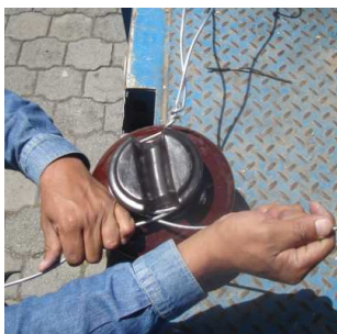
Figura 3.85 Alambre de amarre en aislador
