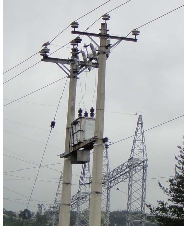
Figura 2.30 Torre de transformación trifásica
