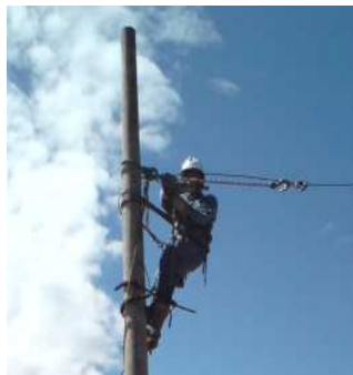
Figura 3.66 Regulación en el poste secundario
