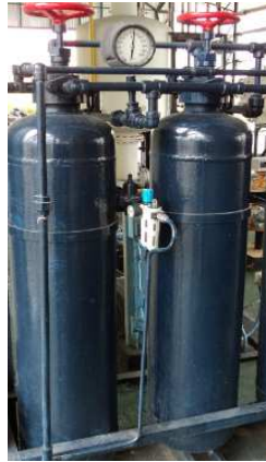
Figura 1.11 Recipientes de aire comprimido
