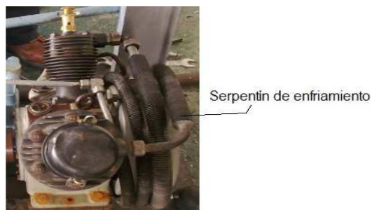
Figura 1.6 Sistema de refrigeración
