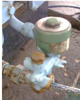
Figura 1.9 Electroválvula del compresor
