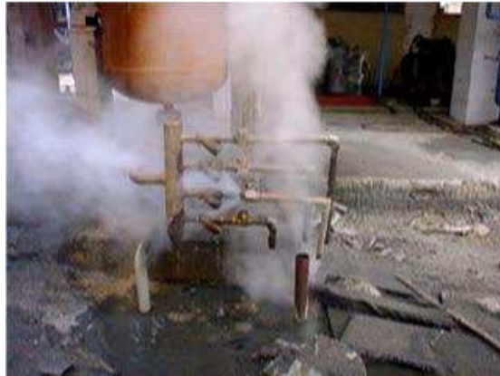
Figura 2.5 Fugas de Vapor [Fuente: propia]
