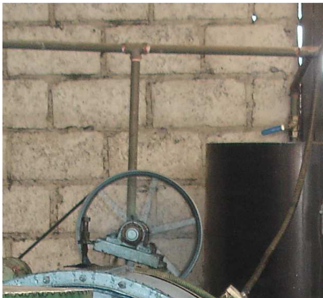
Figura 3.5 Tubería de distribución de vapor.
