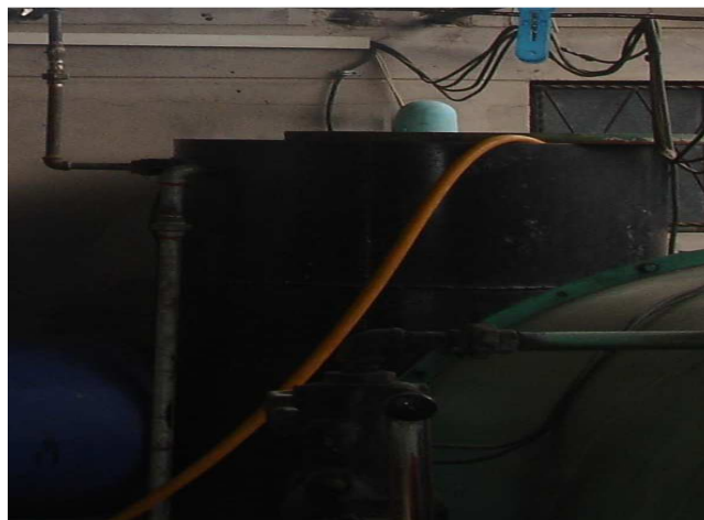
Figura 3.4 Tanque de almacenamiento de agua.
