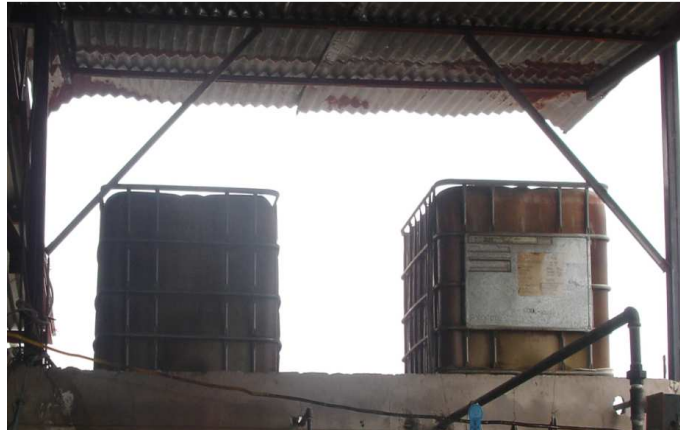
Figura 3.3 Tanque de combustible.
