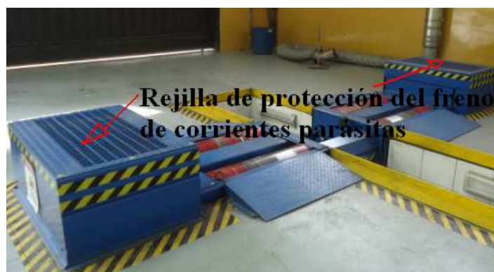
Figura A3.20 Rejilla de protección del freno de corrientes parásitas.
