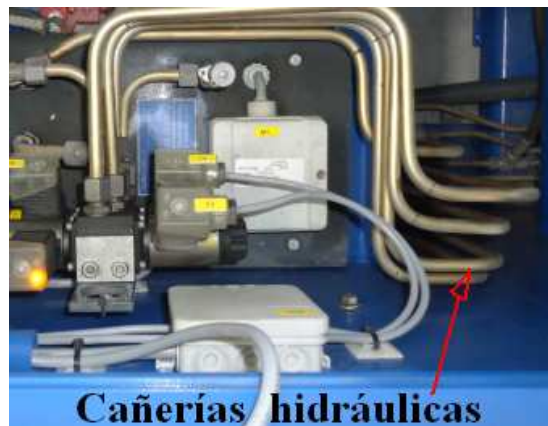
Figura A3.25 Cañerías hidráulicas.
