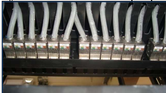
Figura 4-19 Terminaciones de cables en patch panel
