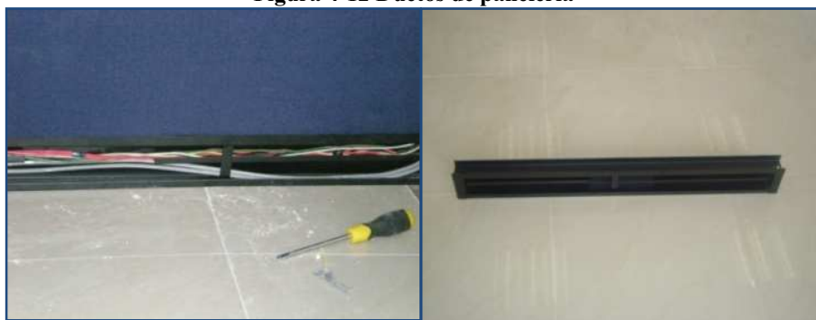
Figura 4-12 Ductos de panelería
