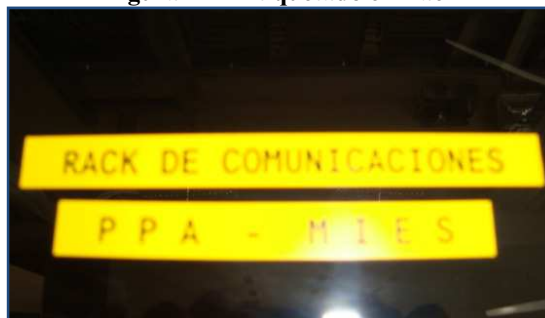
Figura 4-24 Etiquetado en Rack
