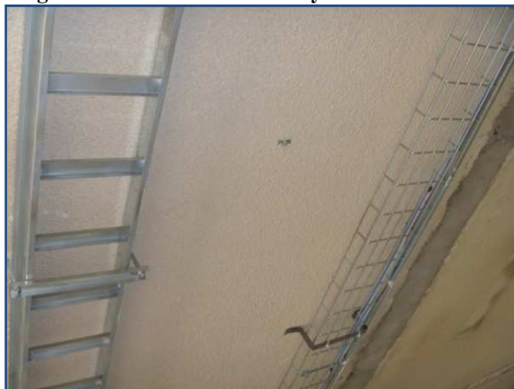
Figura 4-2 Canaleta de Datos y Canaleta Eléctrica
