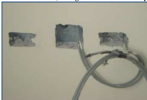
Figura 4-13 Punto de red, energía eléctrica normal y regulada
