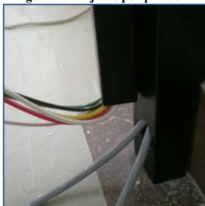
Figura 4-9 Bajante por panelería
