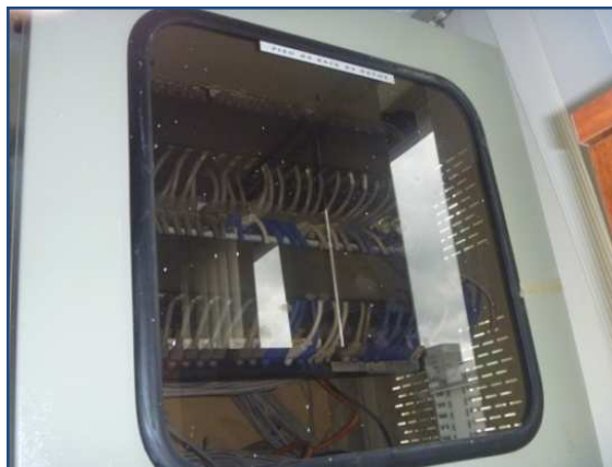
Figura 2-7 Rack aéreo de acceso
