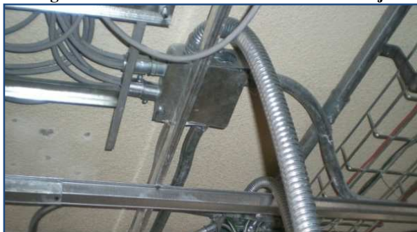
Figura 4-5 Tubería EMT hacia área de trabajo
