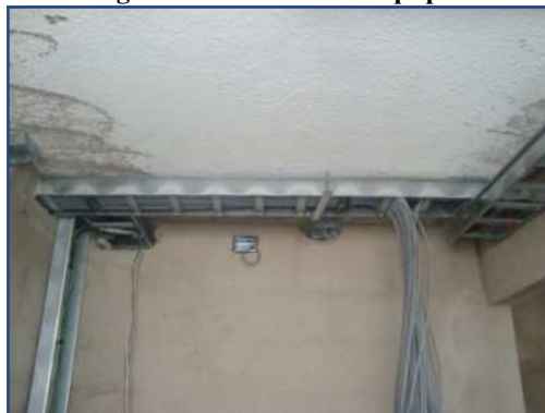
Figura 4-10 Cuarto de Equipos
