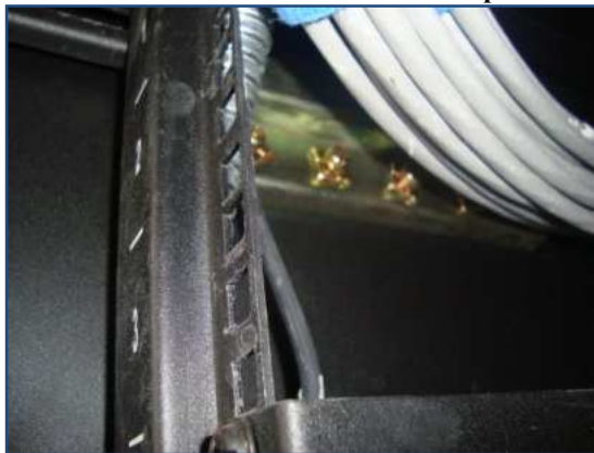
Figura 4-21 Conexión del rack al sistema de puesta a tierra
