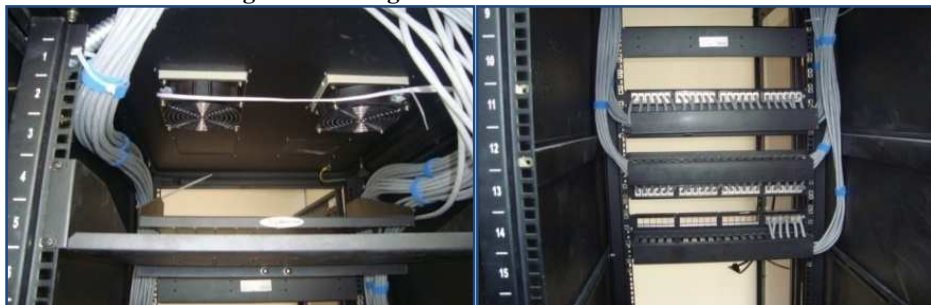
Figura 4-22 Organización de cables en el rack
