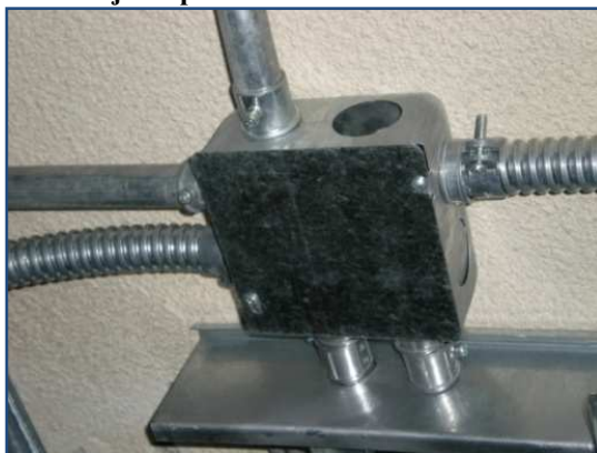
Figura 4-6 Caja de paso: Derivación hacia áreas de trabajo
