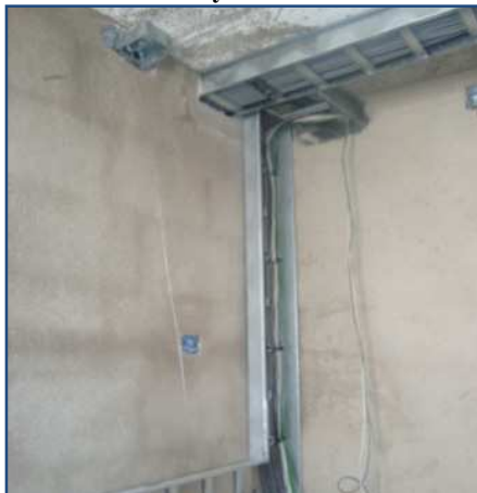
Figura 4-11 Canaleta de datos y eléctrica en cuarto de equipos
