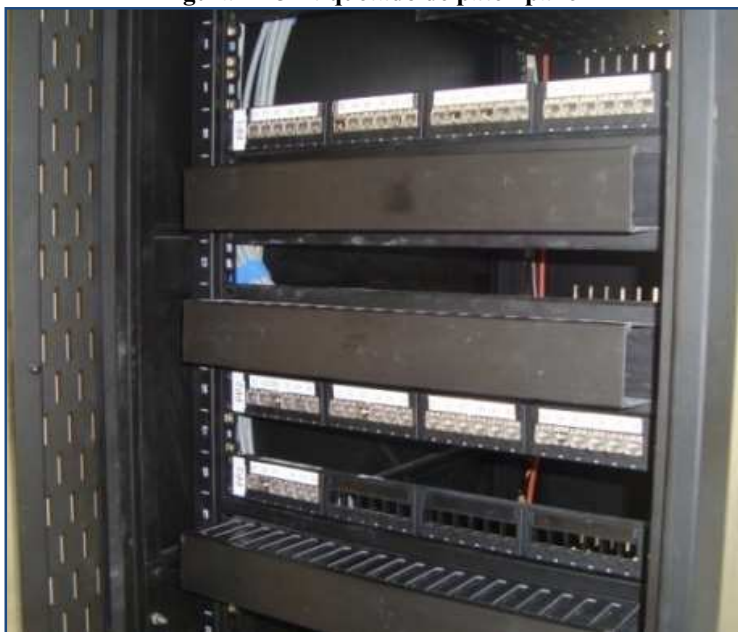
Figura 4-25 Etiquetado de patch panel
