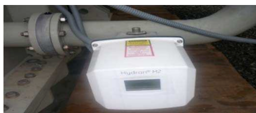
Figura 4.8. Monitor de humedad en tubería de sistema de enfriamiento de transformadores de potencia. [99]
