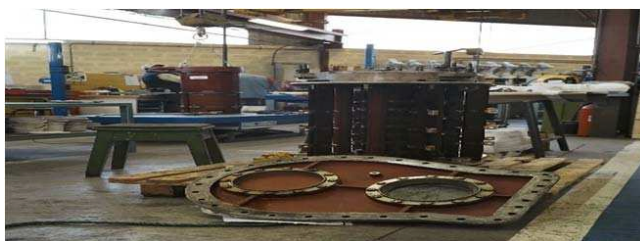
Figura 2.3. Cambiador de tomas vista interna.
