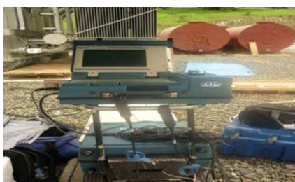
Figura 3.18. Medidor de factor de potencia de aislamiento marca DOBLE.
