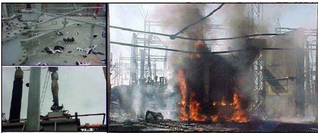
Figura 5.2. Daño en transformadores y equipo asociado.
