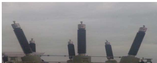
Figura 2.4. Vista de bushing de potencia 230/138kV. (porcelana-aceite).
