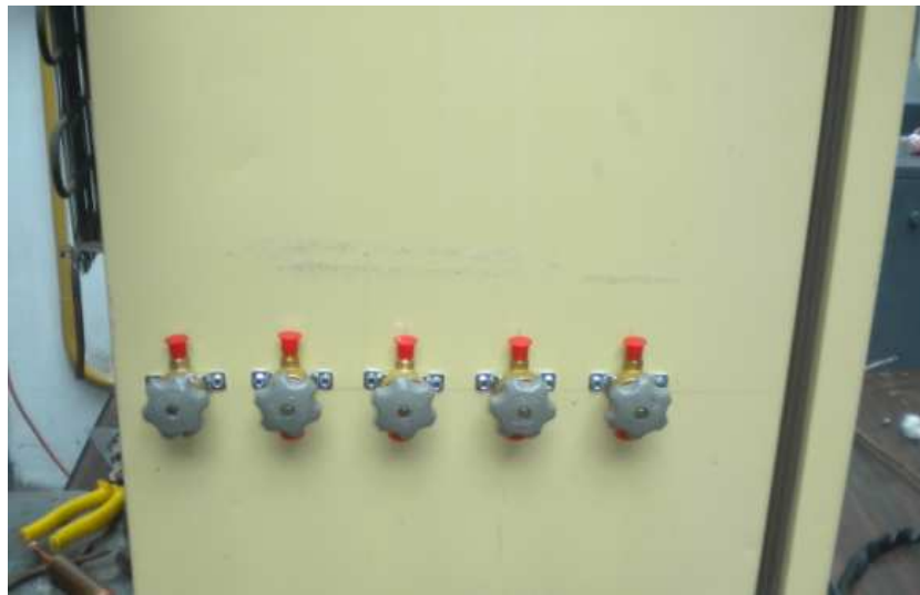
Figura 5.4. Válvulas de paso instaladas en el refrigerador
