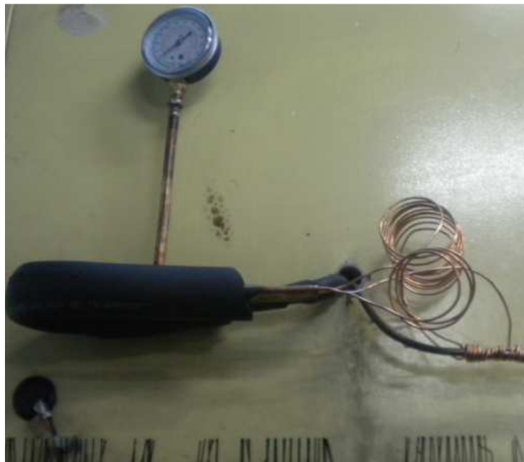
Figura 5.7. Manómetro de baja instalado en el sistema
