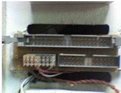
Fig. 3. 27 Puente principal de control
