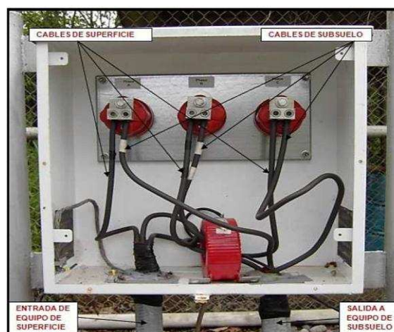
Figura 2.16 CAJA DE CONEXIONES
