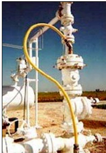
FIGURA 2.18: CABEZAL DEL POZOS
