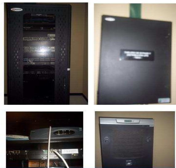
Gráfica 2 Cuarto de Telecomunicaciones Realizado por armando Palaquibay
