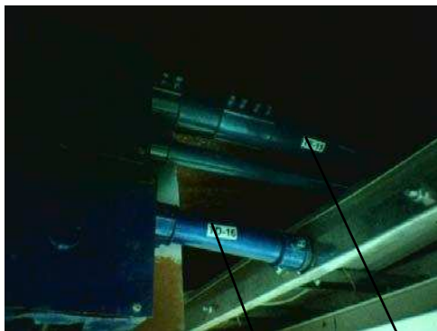
Gráfica 12 Tubería Datos y Eléctricos Realizado por Armando Palaquibay
