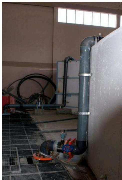
FOTOGRAFÍA No. 5.17: Tubería y accesorios correspondientes al tanque de abastecimiento del Embalse Toachi.
