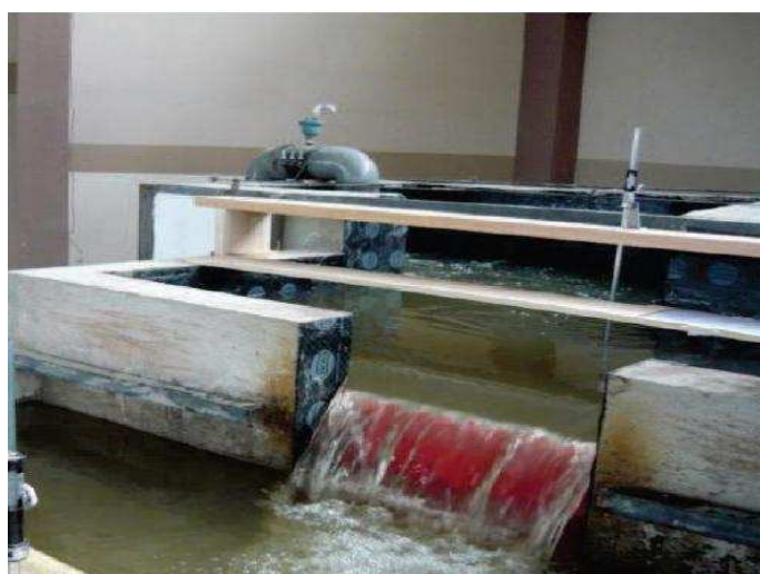
Fotografía No. 11: Vista frontal del vertedero de medida del caudal hacia el túnel de descarga Sarapullo (ubicado en el Tanque No. 1).
