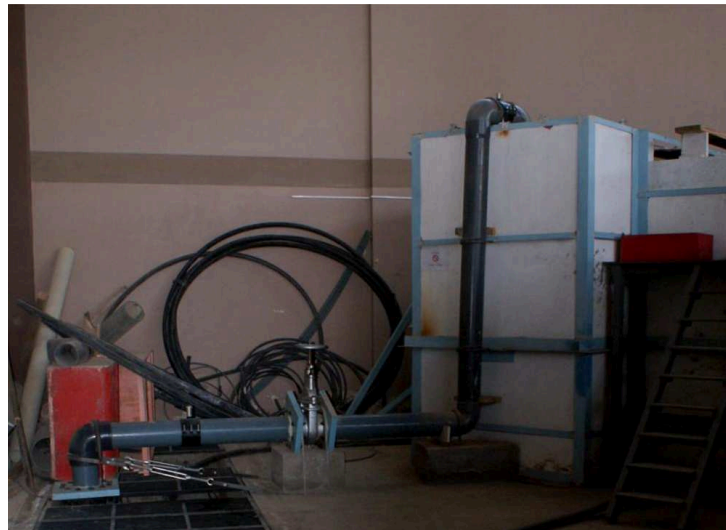
FOTOGRAFÍA No. 5.15: Tubería y accesorios correspondientes al tanque de abastecimiento del túnel de descarga Sarapullo.
