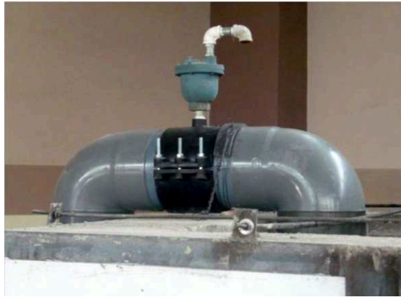
FOTOGRAFÍA No. 5.16: Válvula de aire colocada en la parte superior de la tubería.
