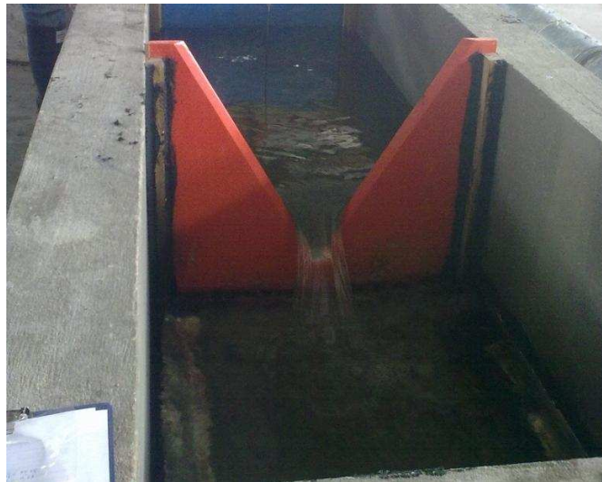
FOTOGRAFÍA No. 5.20: Vertedero triangular 3, en operación.
