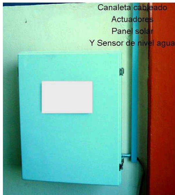
Figura 2.15 Disposición física del tablero de control 60
