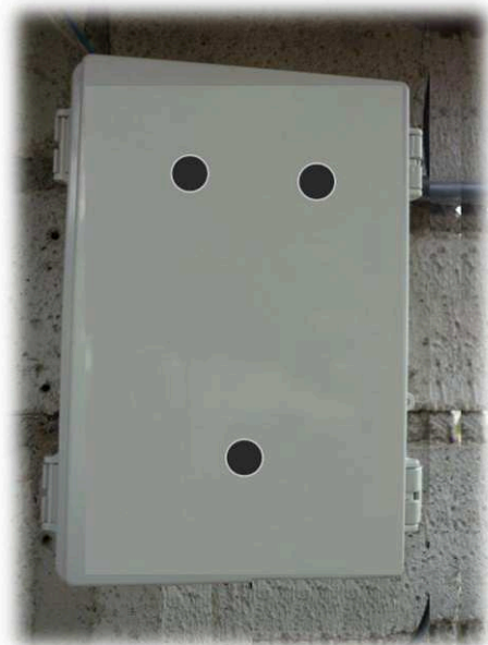
Figura 2.16 Disposición física del tablero de motobomba 61
