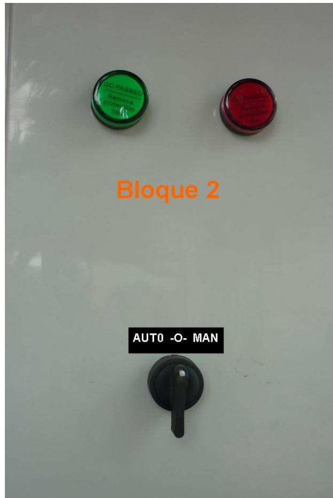
Figura 2.33 Puerta del tablero de motobomba 75
