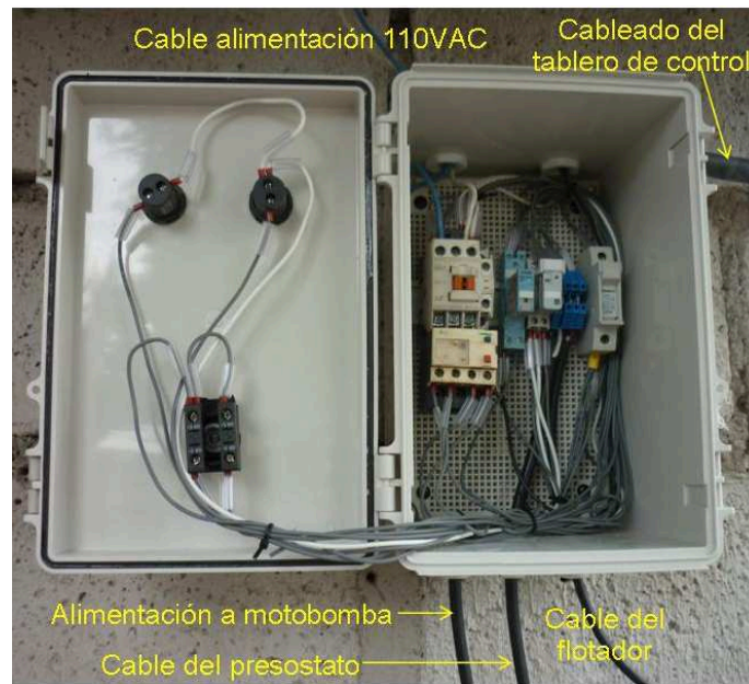
Figura 2.41 Tablero de motobomba terminado 80
