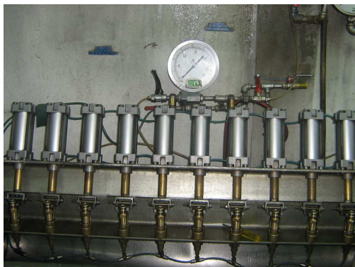
Fig. 24.- Ensayo de válvulas
