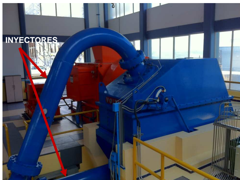
Figura 1.17 Turbina y generador de la central El Carmen
