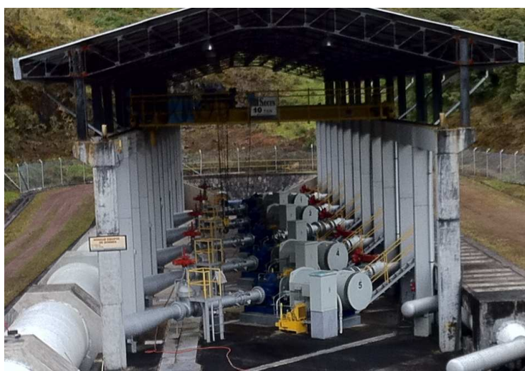
Figura 1.19 Estación de bombeo Booster 2
