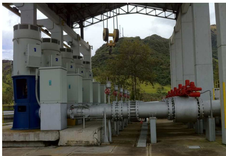
Figura 1.20 Estación de bombeo Elevadora
