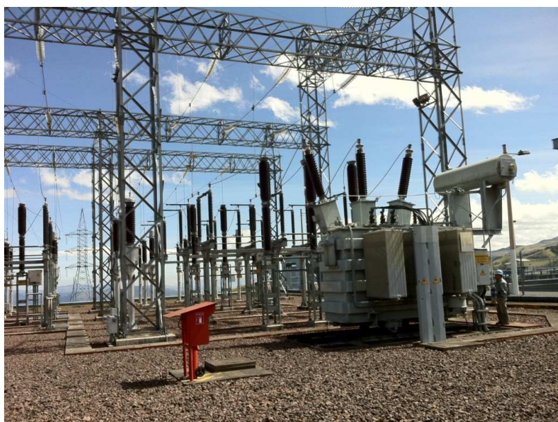
Figura 1.22 Subestación El Carmen
