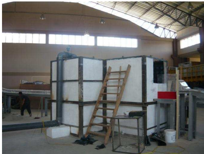
Fotografía No. 3: Vista lateral del Tanque de Entrada a la Descarga Intermedia
