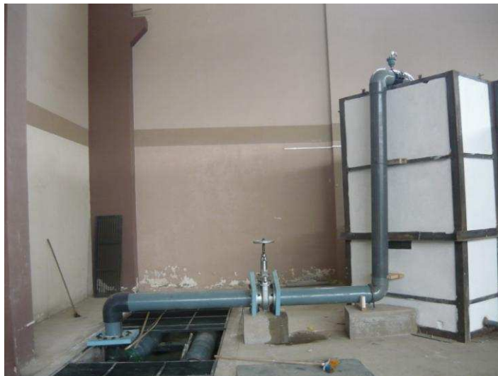
Fotografía No. 7: Vista de la toma (derivación) de agua, válvula de compuerta y accesorios en la tubería hacia el Túnel de Desvío
