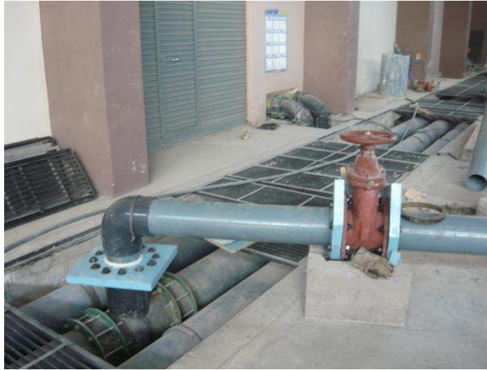
Fotografía No. 6: Vista de la toma (derivación) de agua, válvula de compuerta y tubería hacia el modelo de la Descarga Intermedia
