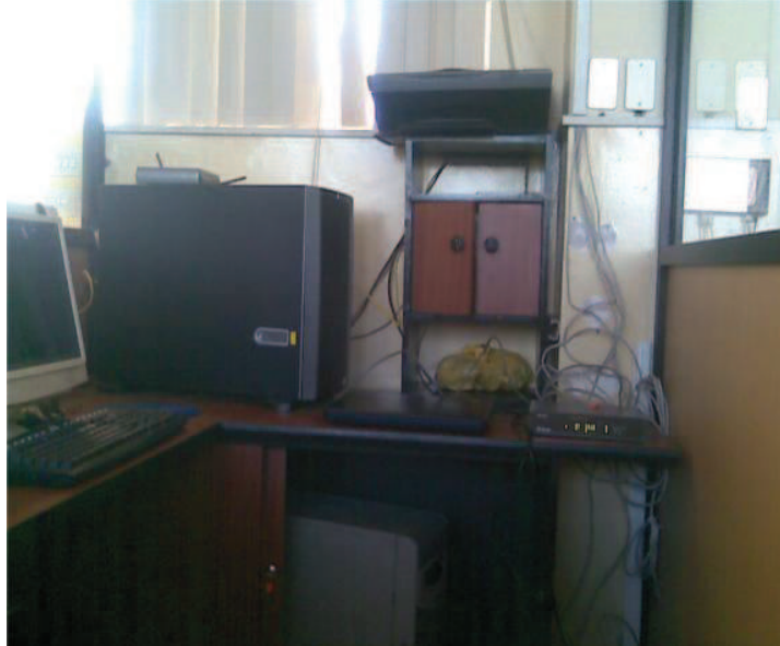
Figura 2. 4 Cuarto de Equipos. [4]
