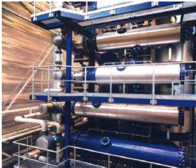
Figura 1.5. Evaporador tubular (Bódalo et al. , 2007)
