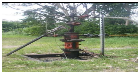
Figura 1.4 CABEZAL DE POZO
