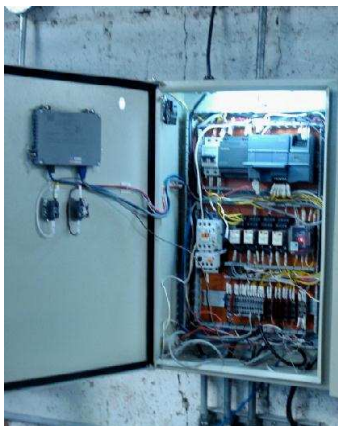
Figura 2.23 Vista frontal del gabinete 1.
