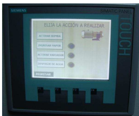
Figura 4.15. Pantalla que indica que la bomba está trabajando
