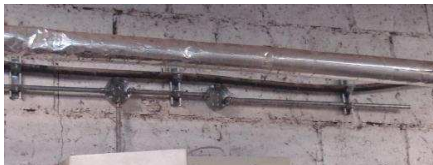
Figura 2.26 Tuberías de los cables de alimentación de los gabinetes
