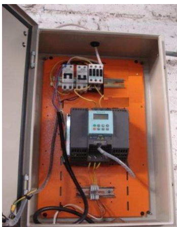
Figura 2.23 Vista frontal del gabinete 2
