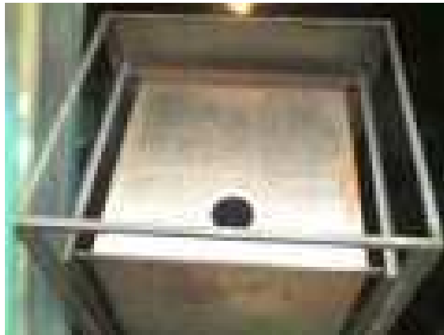
Figura 3.20 Espacio donde estara montado el dispositivo de circulación de aire forzado
