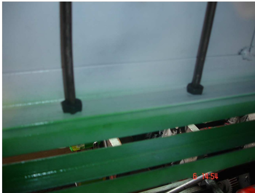
Figura 3.13 fotografía de la porta resistencias, ya colocadas en su respectivo sitio
