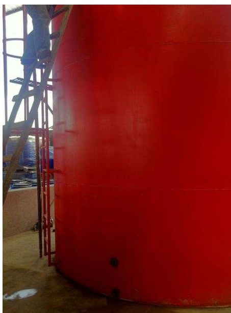
Figura 3. 38 – Boquillas de visor de nivel y drenaje.
