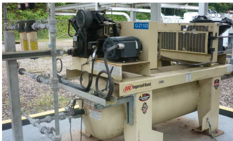
Figura 3.24: Compresores de aire
