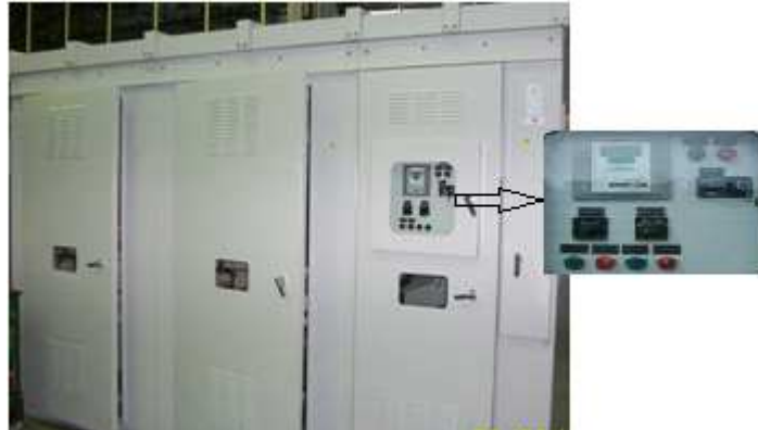
Figura 2.54: Banco de capacitores
