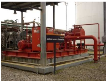
Figura 3.215: Bombas sistema contra incendios
