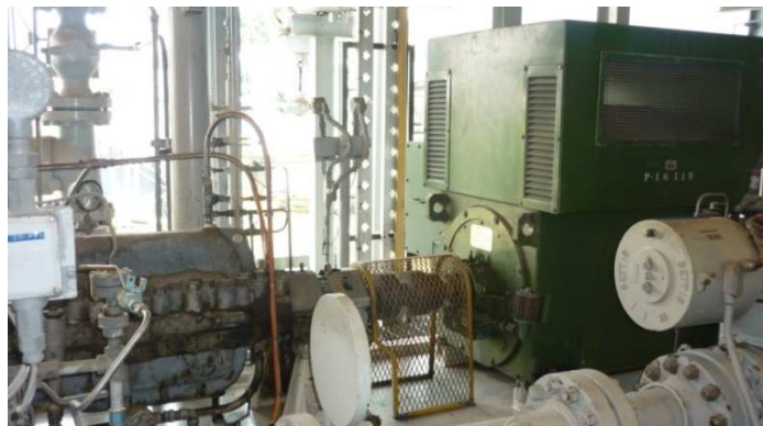
Figura 3.261: Bombas de transferencia
