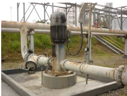
Figura 3.233: Bombas booster de agua de formación
