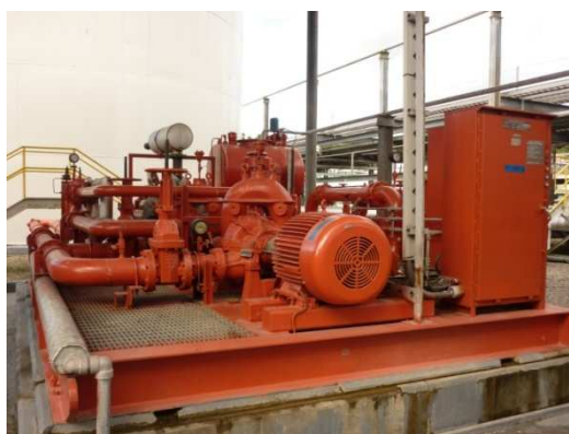
Figura 3.251: Bombas sistema contra incendios
