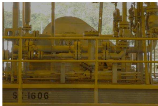
Figura 3.265: Bombas de transferencia
