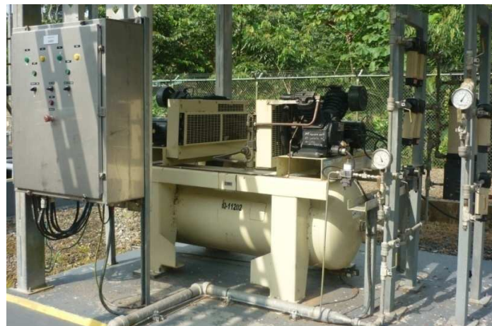
Figura 3.181: Compresores de aire
