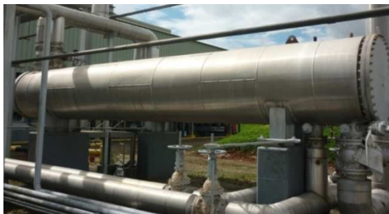
Figura 3.260: Intercambiador de calor
