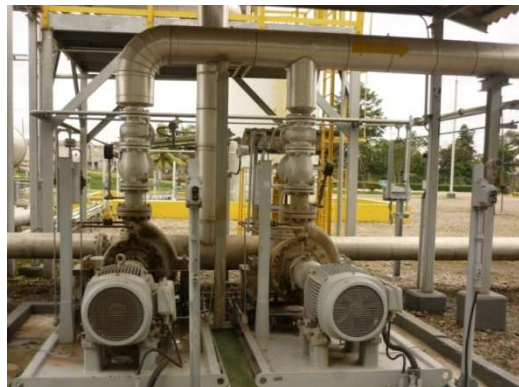
Figura 3.267: Bombas de Recirculación
