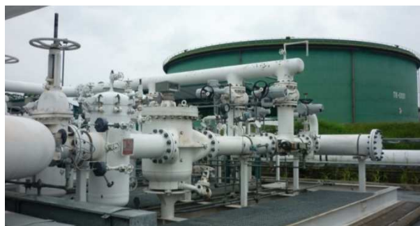
Figura 3.279: Sistema de medición OCP
