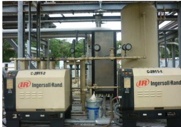
Figura 3.50: Compresores de aire
