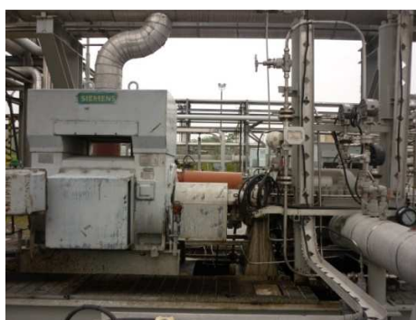
Figura 3.193: Bombas de Transferencia
