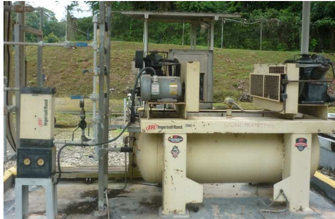
Figura 3.77: compresores de aire
