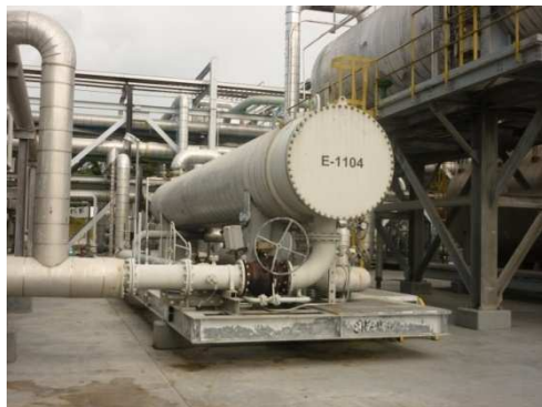
Figura 3.224: Intercambiador de calor
