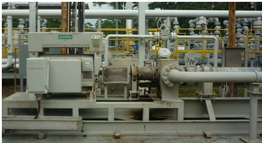
Figura 3.61: bombas de alta presión P-9111
