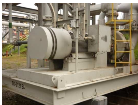
Figura 3.196: Bombas booster de agua de formación
