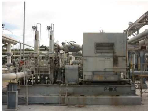
Figura 3.230: Bombas de Transferencia
