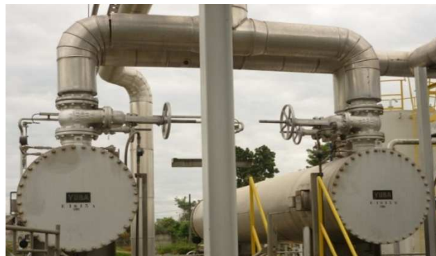
Figura 3.269: Intercambiador de Calor
