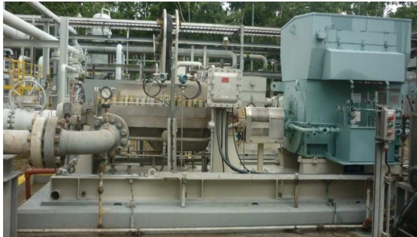
Figura 3.60: bombas de alta presión P-2079 V
