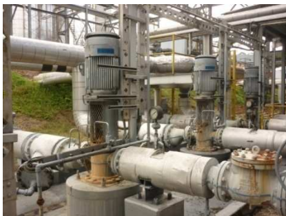
Figura 3.229: Bomba booster de crudo
