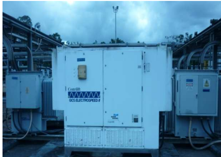
Figura 2.41: Transformador y variador de frecuencia
