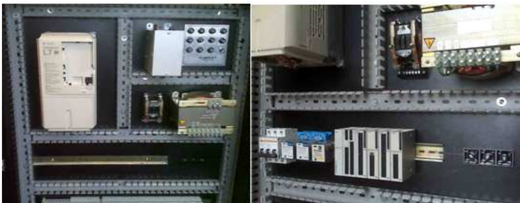
Figura 2.18 - Representación de los equipos del tablero de control.
