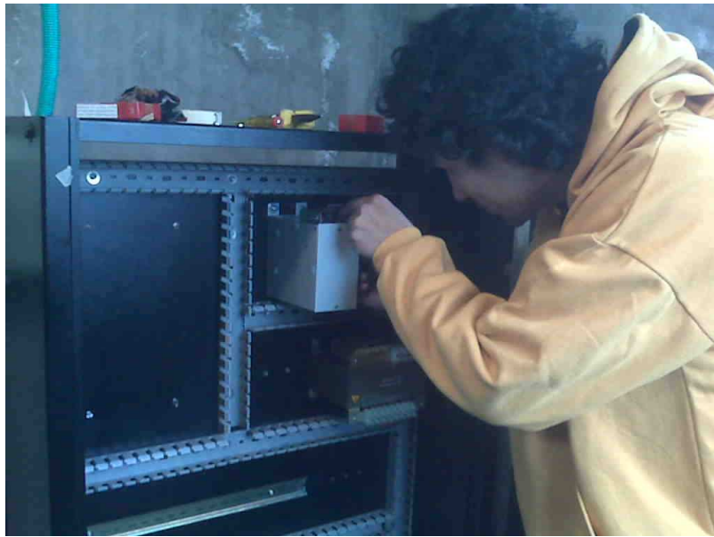
Figura 2.17 - Instalación de los equipos en el tablero de control.
