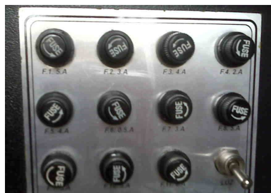
Figura 2.7 - Caja de fusibles.
