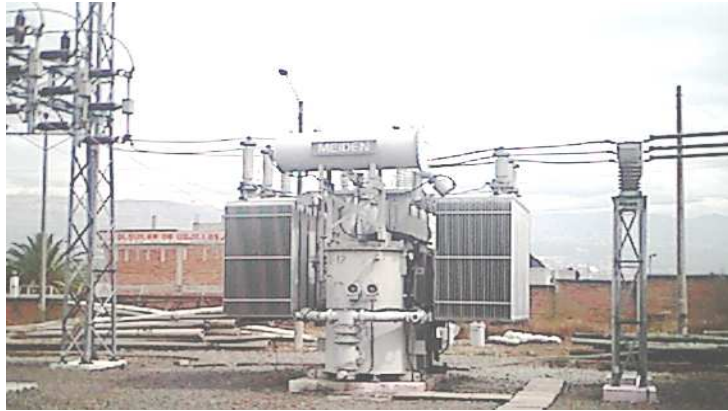
Figura 2.18 Transformador de potencia 46/23 kV S/E San Rafael
