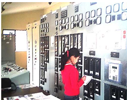
Figura 2.16 Tablero de comando S/E San Rafael
