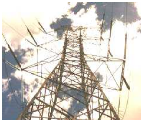
Figura 2.3 Líneas aéreas de transmisión eléctrica [74]
