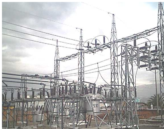
Figura 2.17 Alimentación del parque de 46 kV S/E San Rafael
