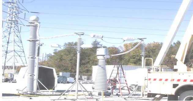
Figura 2.4 Subestación de transformación [100]
