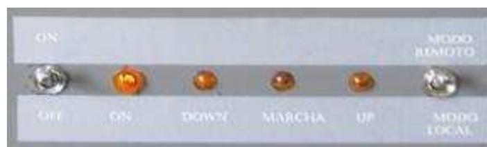
Figura 4. 16 Interruptores e indicadores del Panel de Supervisión
