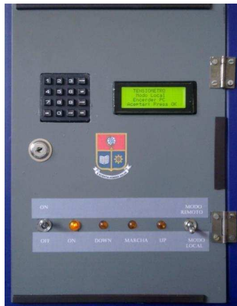
Figura 4. 13 Vista frontal del Panel de Supervisión del Tensiómetro
