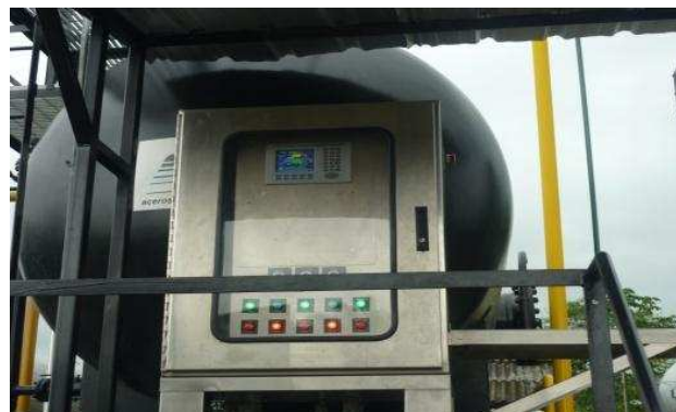
FOTO 1.24 CONSOLA DE CONTROL SEPARADOR DE PRODUCCIÓN
