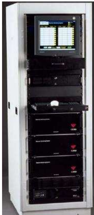
Figura 4.9 SISTEMA DE MONITOREO DE FIBRA ÓPTICA
