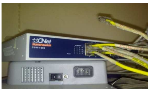
Figura 2.23 Cuarto de Equipos Patronato Municipal
