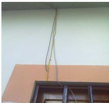
Figura 2.24 Cableado Vertical Biblioteca Municipal.
