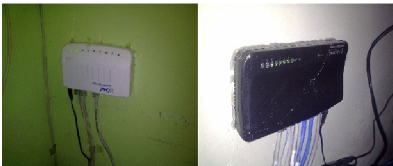
Figura 2.28 Equipos de Acceso
