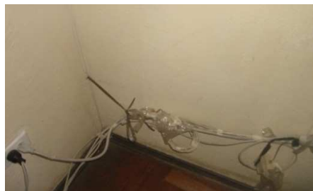
Figura 2.25 Cableado UTP del Palacio Municipal-Obras Públicas
