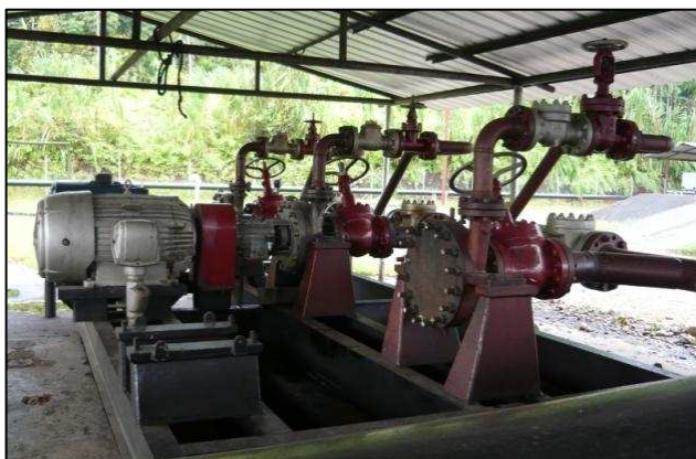
FIGURA A.9.16 BOMBAS DE TRANSFERENCIA – ESTACIÓN TETETE
