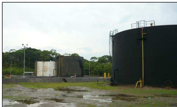
FIGURA A.9.15 TANQUE DE LAVADO – ESTACIÓN TETETE
