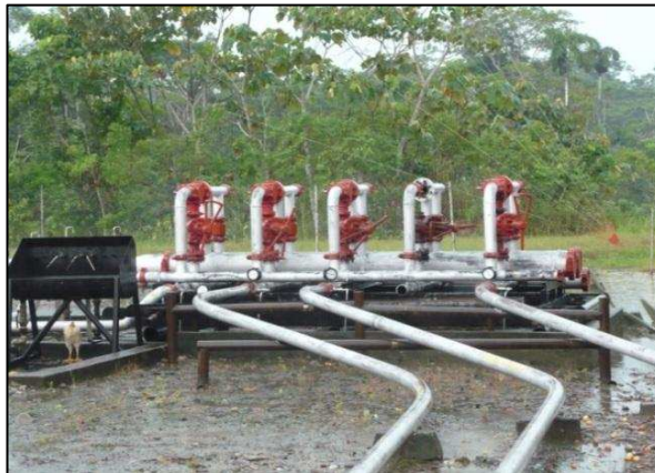
FIGURA A.9.8 MANIFOLD – ESTACIÓN TAPI
