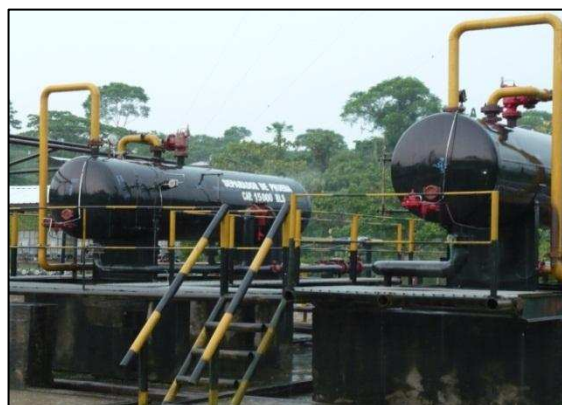
FIGURA A.9.9 SEPARADORES – ESTACIÓN TAPI
