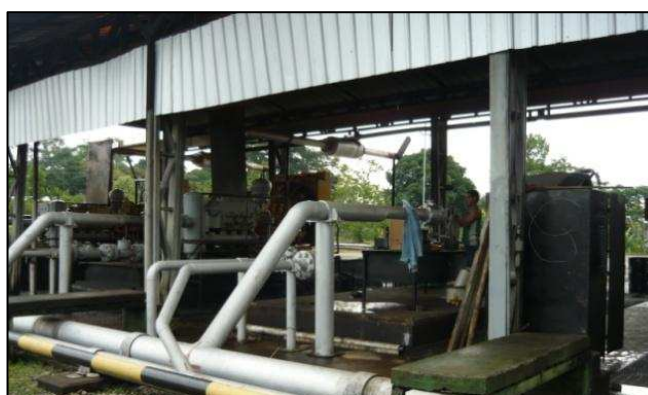
FIGURA A.9.18 UNIDADES DE BOMBEO WEATLEY – ESTACIÓN TETETE
