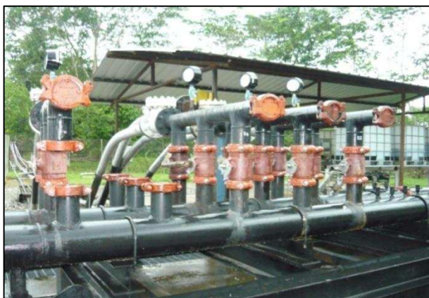
FIGURA A.9.1 MANIFOLD – ESTACIÓN FRONTERA
