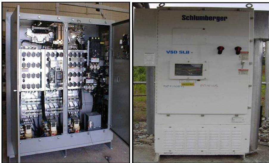
FIGURA 1.50 VARIADOR DE FRECUENCIA
