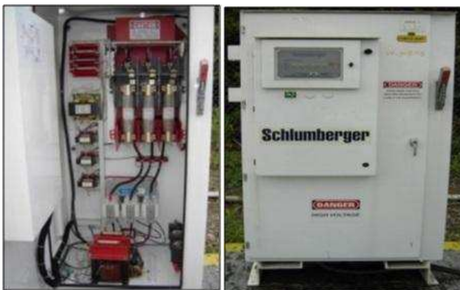
FIGURA 1.49 TABLERO DE CONTROL
