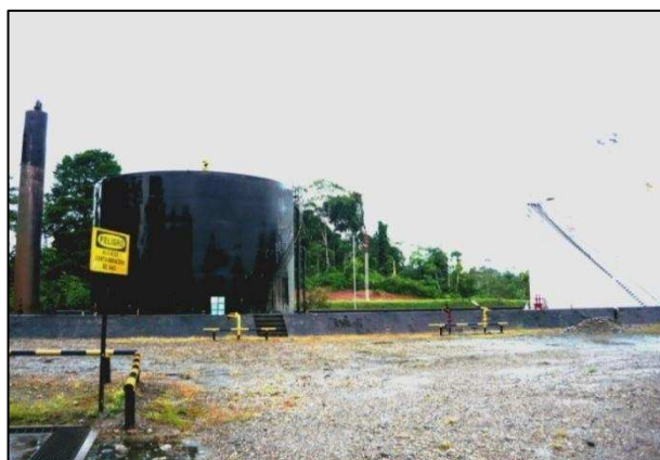
FIGURA A.9.3 TANQUE DE LAVADO – ESTACIÓN FRONTERA
