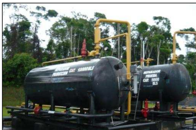
FIGURA A.9.2 SEPARADORES – ESTACIÓN FRONTERA
