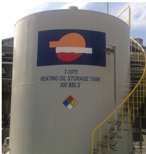
FIGURA 2. 1 Tanque de almacenamiento de aceite térmico
