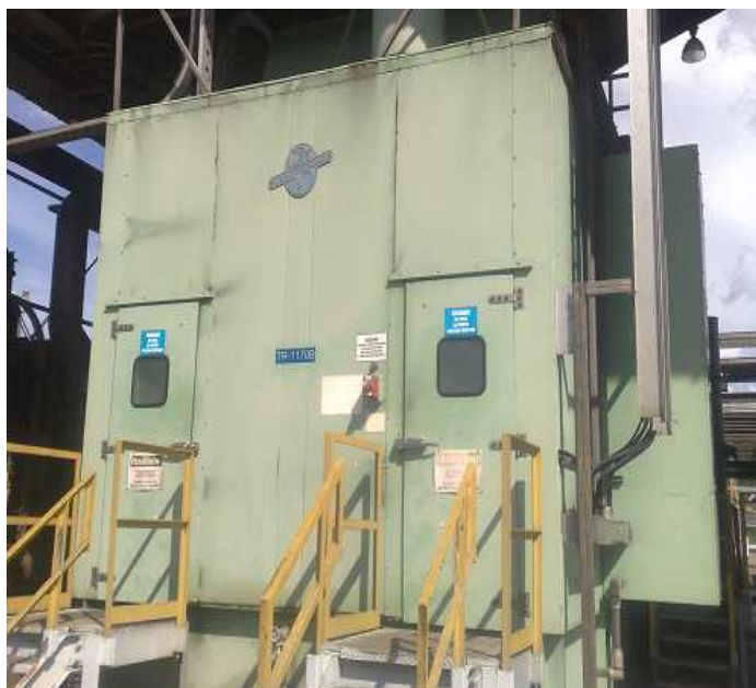
FIGURA 2. 6 TURBINAS GE LM2500
