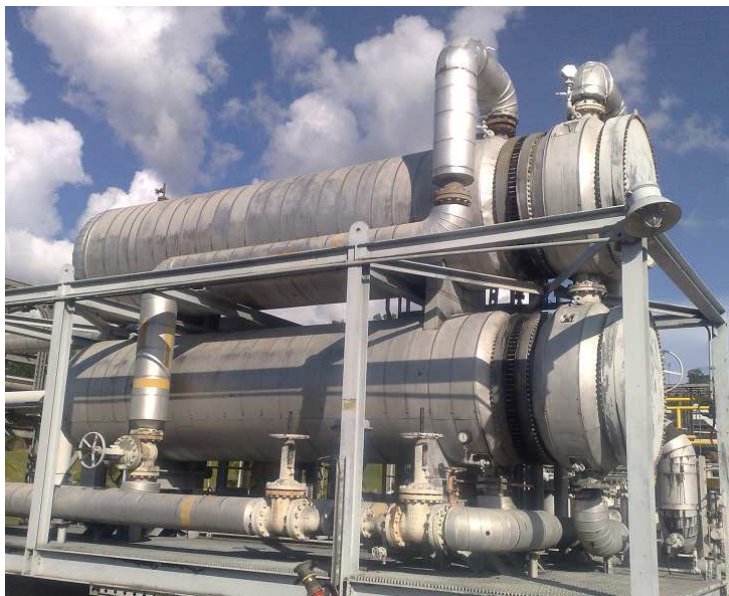
FIGURA 2. 7 Intercambiador de Calor E-1160
