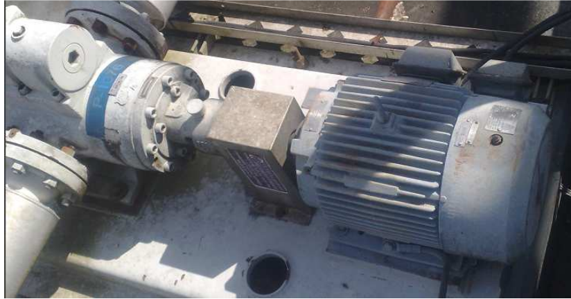
FIGURA 2. 2 Bomba de Transferencia P-1076
