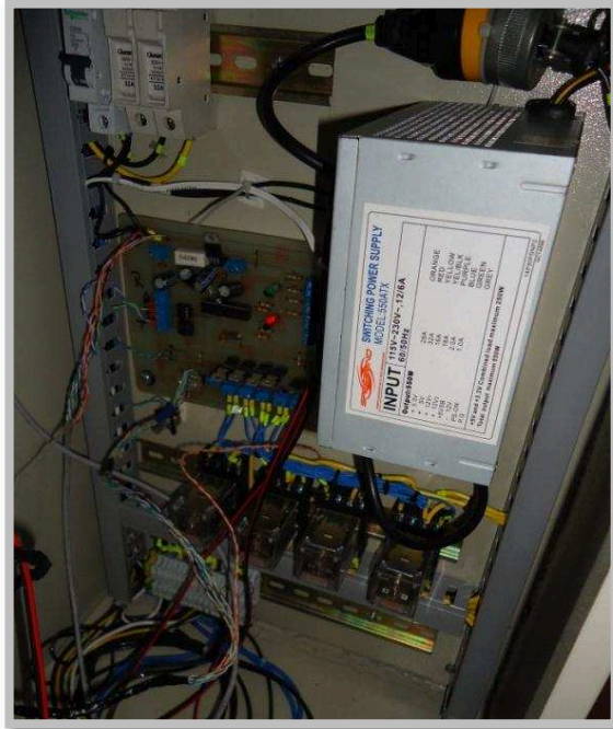
Figura 4. 1 Tablero de Control de Iluminación
