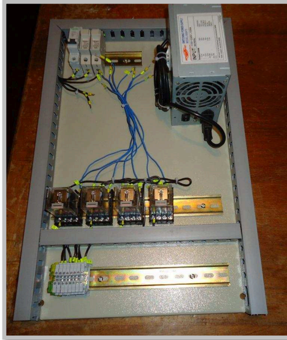
Figura 4. 4 Tablero de Control, Contiene los relés que manejan el control de luces.
