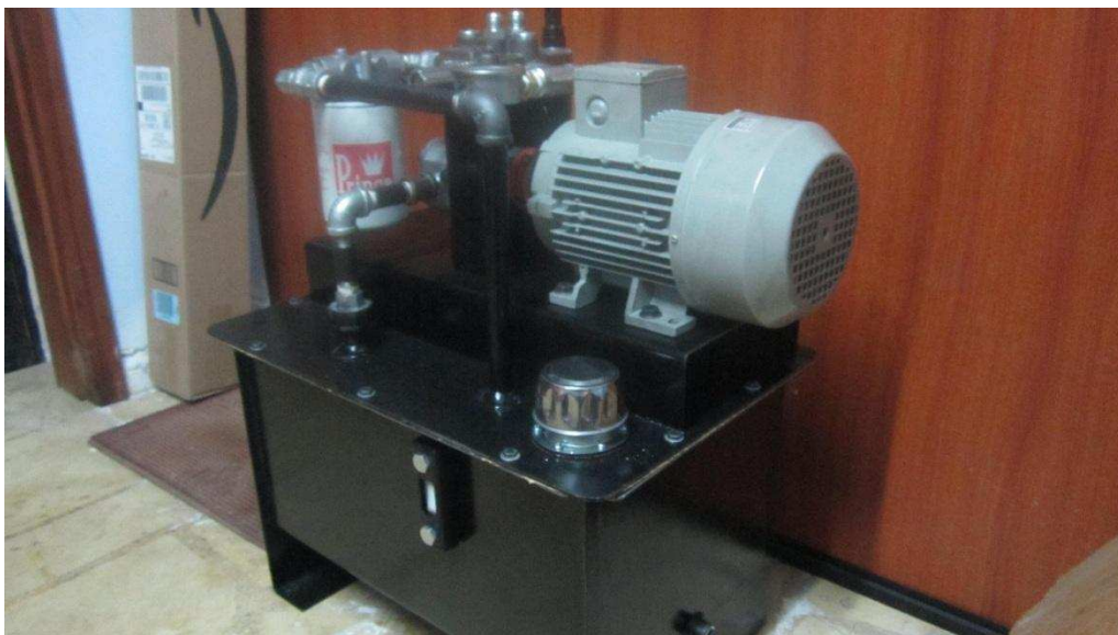
Figura 5-2: Unidad hidráulica pre-ensamblada 2
