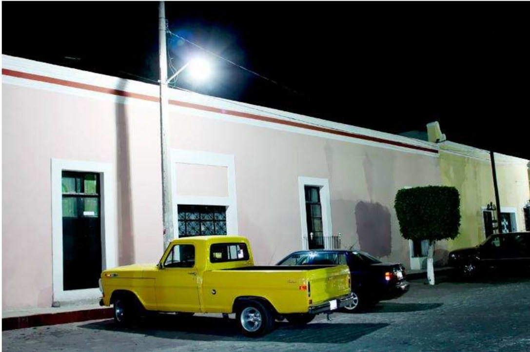
Fig. 6.17. Iluminación de una vía pública mediante lámparas de inducción externa
