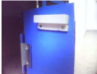
FIG 2.24: Reed switch instalado en la casa prototipo.
