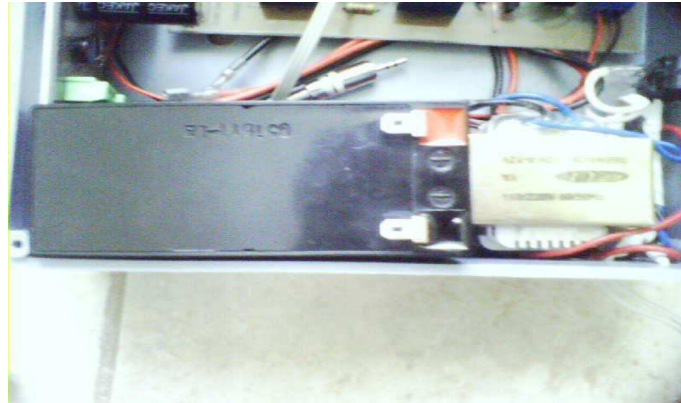
FIG 2.10: Transformador y batería de respaldo dentro de la caja.
