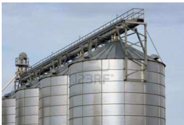
Figura 2.4. Tanque de almacenamiento tipo techo fijo tipo Cónico. 3
