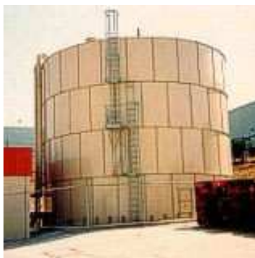
Figura 2.7. Tanque de almacenamiento empernado. 7
