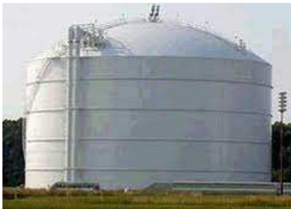
Figura 2.3. Tanque de almacenamiento tipo techo fijo tipo domo. 2
