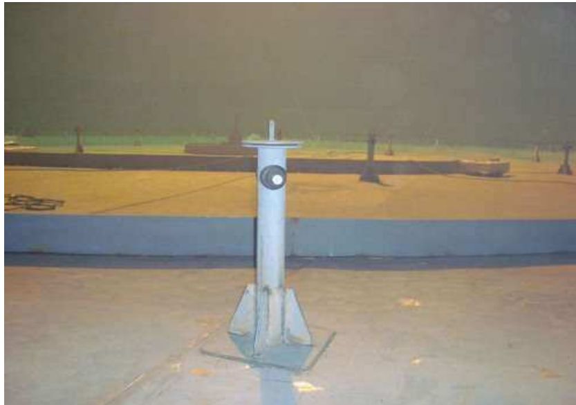
Figura. 5. 12 Soportes techo flotante.
