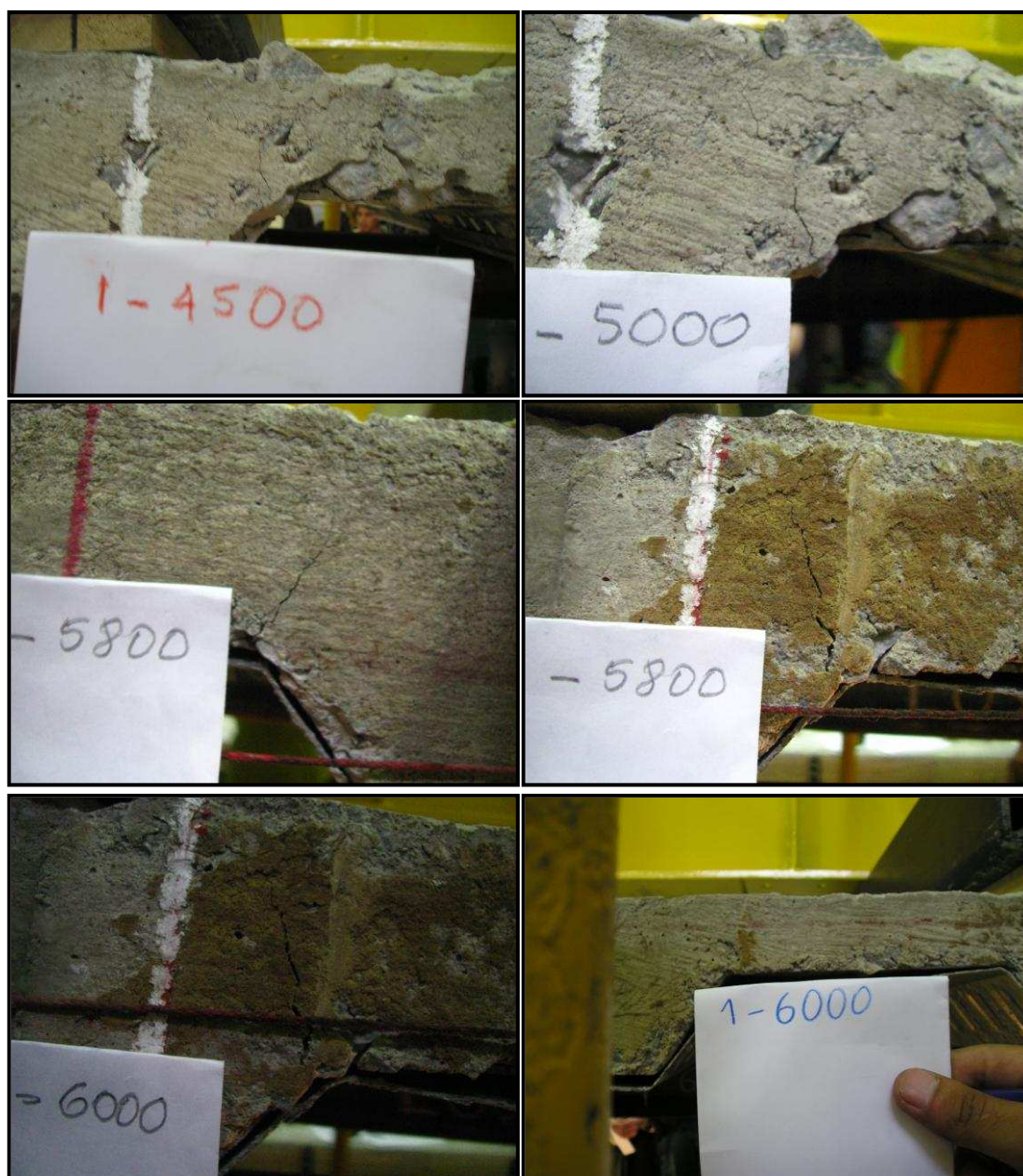
FOTO 4.2. FISURAS PRESENTADAS DURANTE LOS DISTINTOS CICLOS DE CARGA
