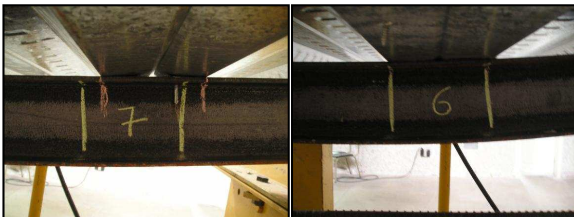
FOTO 4.3. DESPLAZAMIENTO HORIZONTAL DE LOS DISTINTOS VALLES
