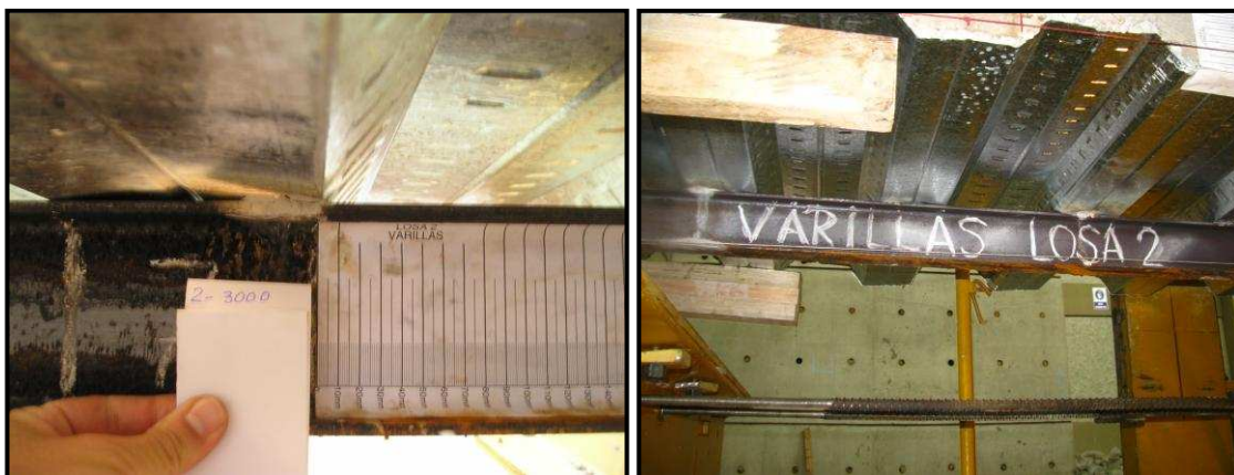
FOTO 4.7. VISTA POR DEBAJO DE LA SECCIÓN COMPUESTA DONDE SE EVIDENCIA LA CARENCIA DE DESPLAZAMIENTOS HORIZONTALES Y SU FIJACIÓN VIGA-DECK
