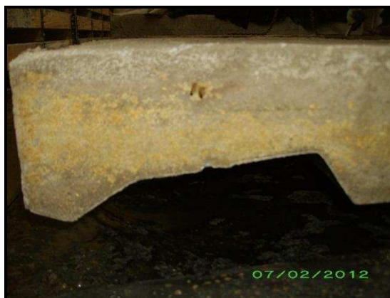
FOTO 3.20. IMPERFECCIONES EN EL ENCOFRADO DE LAS LOSAS
