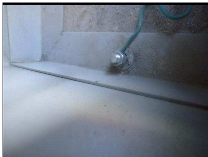
Figura: 3.4 Conexión a tierra del validador
