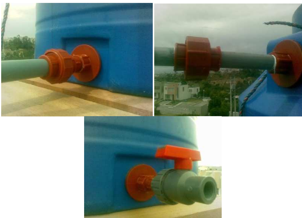
Figura 3.40- Accesorios del tanque.
