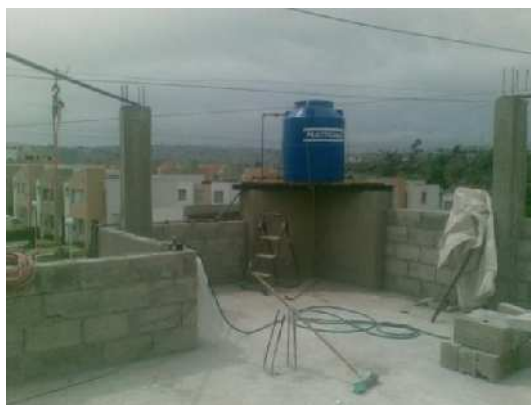
Figura 3.36- Fotografía del tanque.
