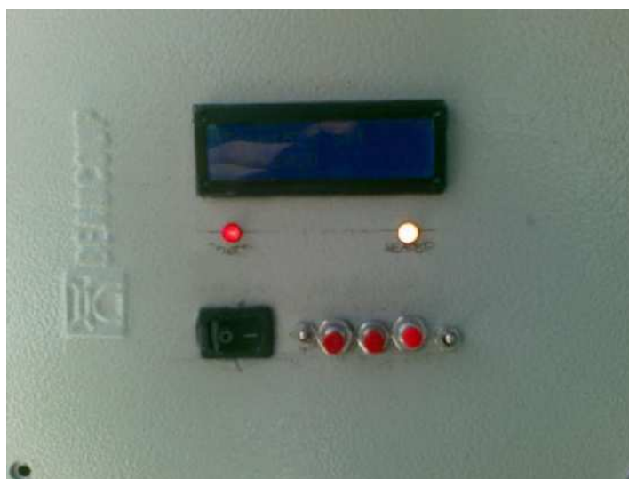
Figura 5.7- Caja controladora del sistema.
