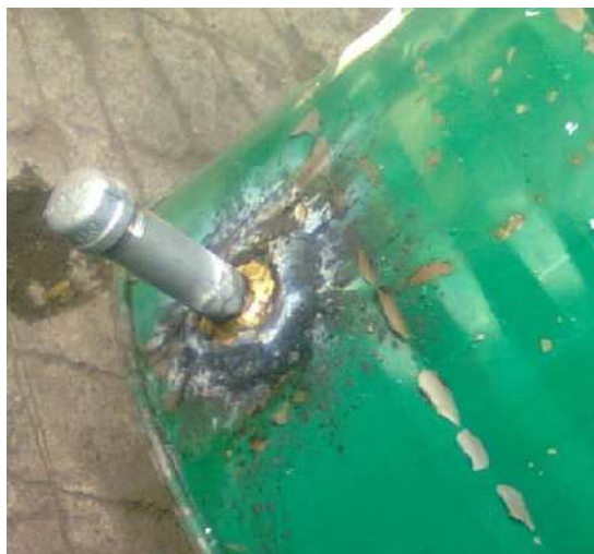
Figura 3.24- Salida de agua del tanque soldada.
