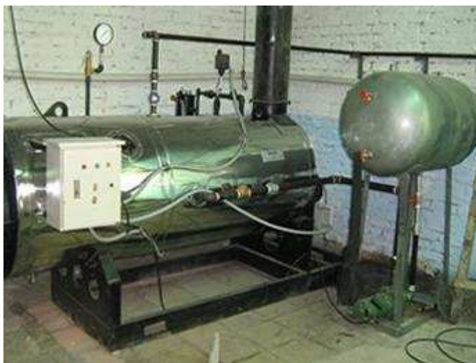
Figura 2.4- Caldera de gas.
