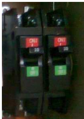
Figura 5.2- Protección eléctrica, Breaker QO115 S.D. Interruptor de 1 polo, 30 Amperios 120 Voltios.
