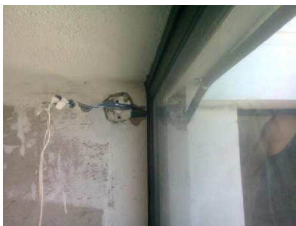
Figura 5.4- Toma del cajetín ubicado en el tercer piso.
