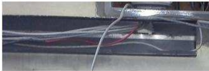
Figura 2.7 Cables de red expuestos en el cableado actual
