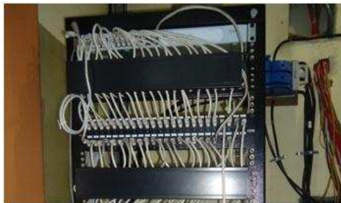
Figura 2.10 Equipos cerca de cables de alimentación eléctrica
