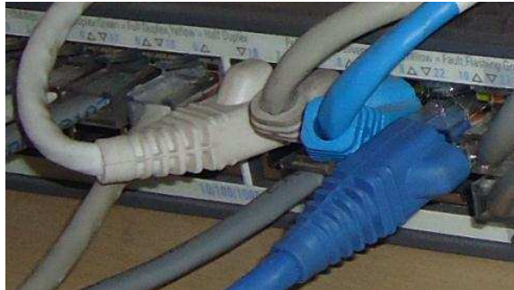
Figura 2.9 Cables de red con curvaturas incorrectas
