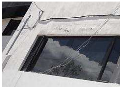
Figura 2.8 Cables guiados fuera del edificio principal
