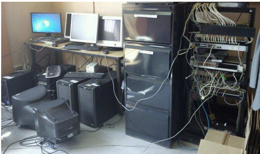
Figura 2.12 Cuarto de equipos
