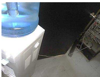
Figura 2.13 Utilización de las tomas eléctricas del rack en otros fines
