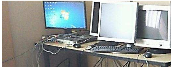
Figura 2.11 Ubicación del switch de núcleo
