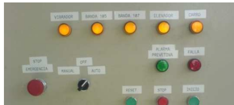
Figura 4.18 Tablero de Control en Campo
