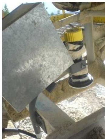
Figura 4.48 Instalación Sensor de Nivel en Campo
