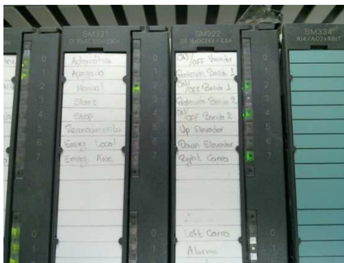
Figura 4.22 Módulo de Salidas Digitales del PLC
