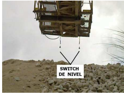
Figura 4.34 Switch de Nivel de la Cinta Inclinada
