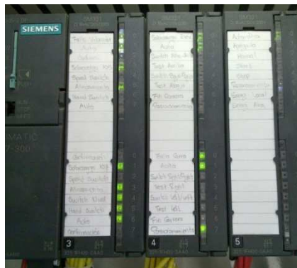
Figura 4.19 Módulos de entradas digitales del PLC
