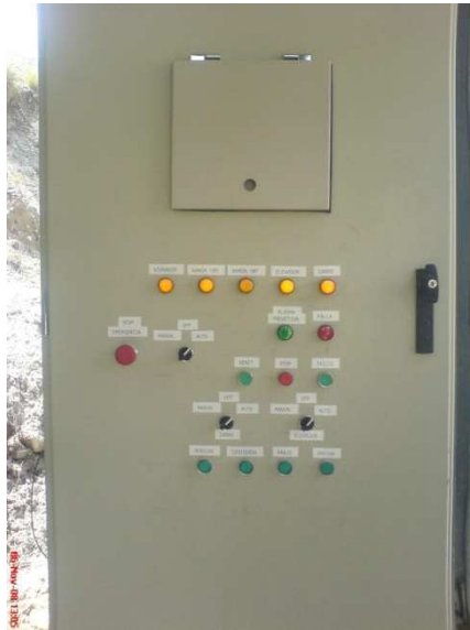
Figura 4.17 Tablero de Control en Campo
