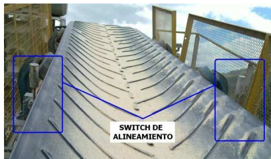
Figura 4.33 Switch de Alineamiento de Cinta Transportadora
