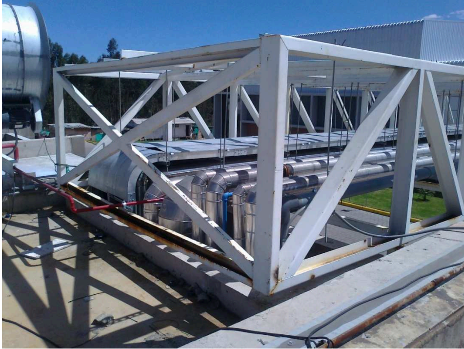
Fig. 4.22: Salida de las tuberías a través de losa de Casa de Fuerza 166
