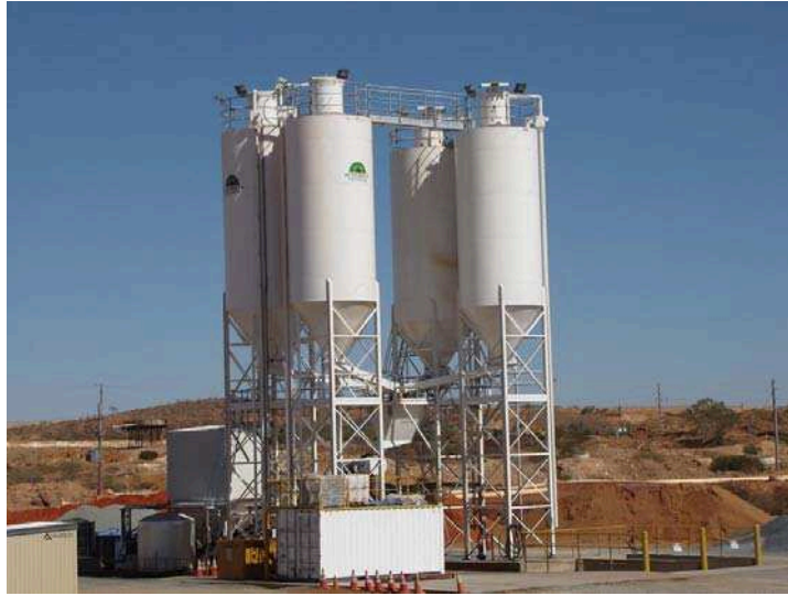
Fig. 1.2: Tanques de almacenamiento de Cemento 2 ,
