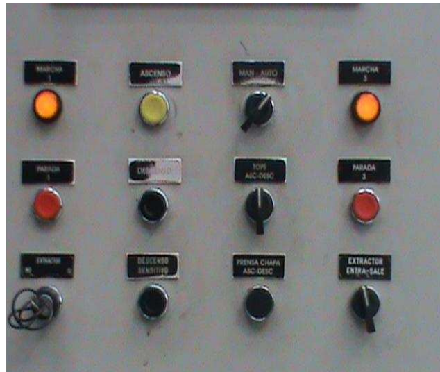
Figura 2.4 Botoneras del Panel de Control Prensa 1000 Ton.
