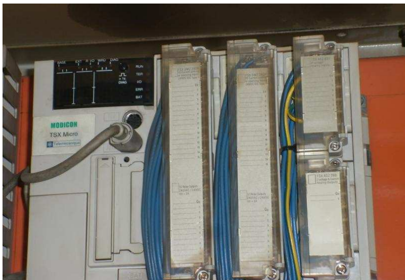
Figura 4.2 PLC Telemecanique instalado en la prensa
