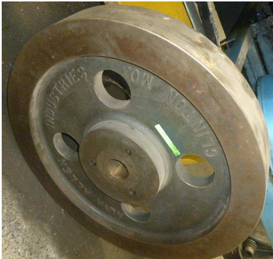
Fotografía 2.10. Estado actual del volante de inercia
