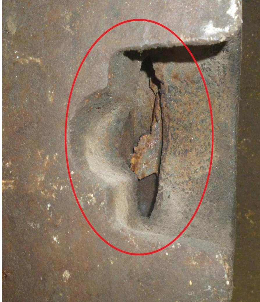
Fotografía 2.16. Corrosión en la base del martillo
