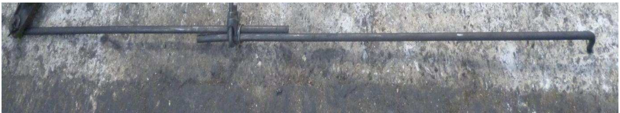
Fotografía 2.22. Estado actual de la barra de accionamiento
