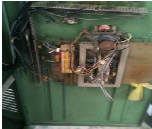
Figura 2.36 Equipo interno del tablero de control Elaborado por: Lucas Infante y Fredy Cabascango
