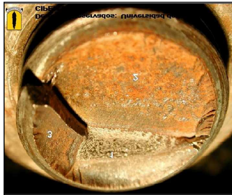
Fig. 3.10 Falla por Sobrecarga en tensión y torsión
