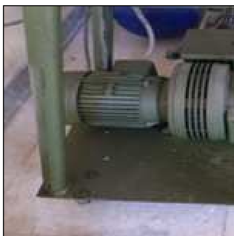
Fig. 4.31 (c) Motor bomba de vacío
