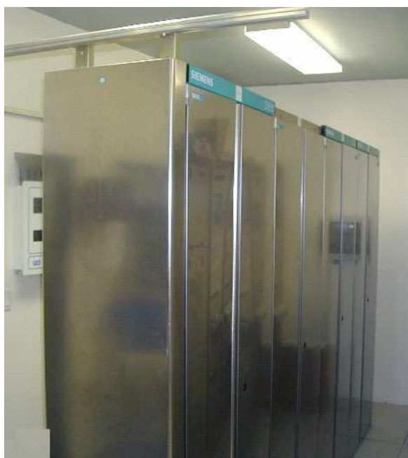
Figura 3.1 Concentrador SIEMENS DLU-B [3]
