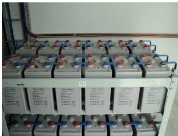
Figura 3.42 Banco de Baterías de 24 celdas
