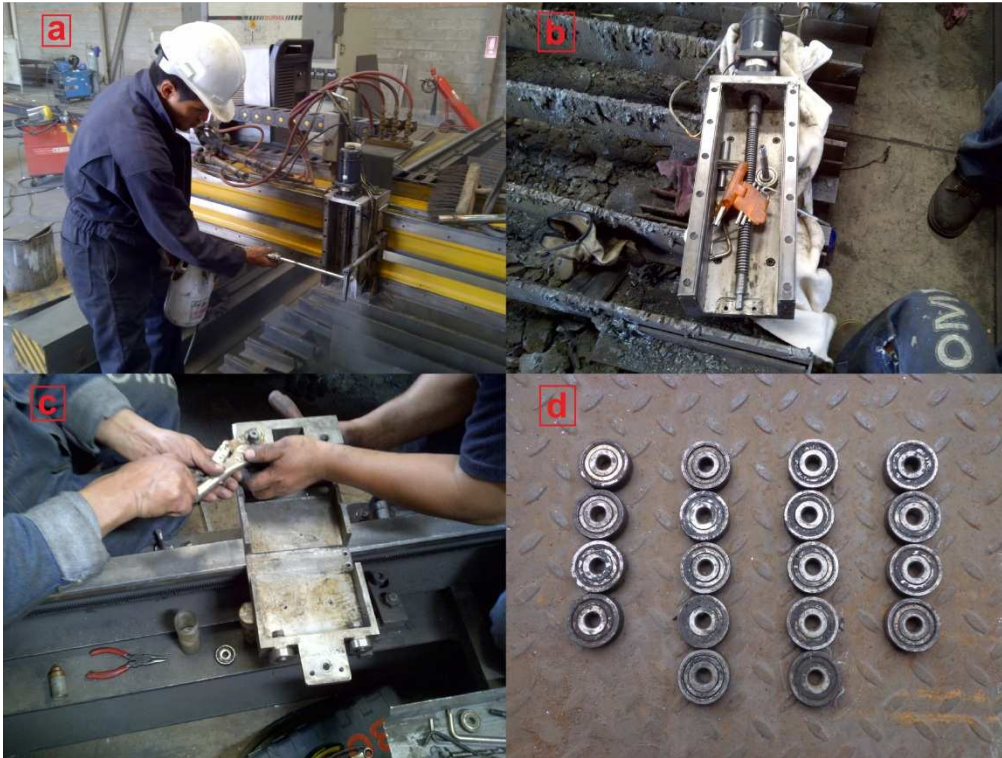
Figura 4.20 Acciones correctivas sobre las antorchas; a) Limpieza del dispositivo de levantamiento; b) Desmontaje del dispositivo de levantamiento; c) Colocación de rodamientos nuevos; d) Rodamientos defectuosos.
