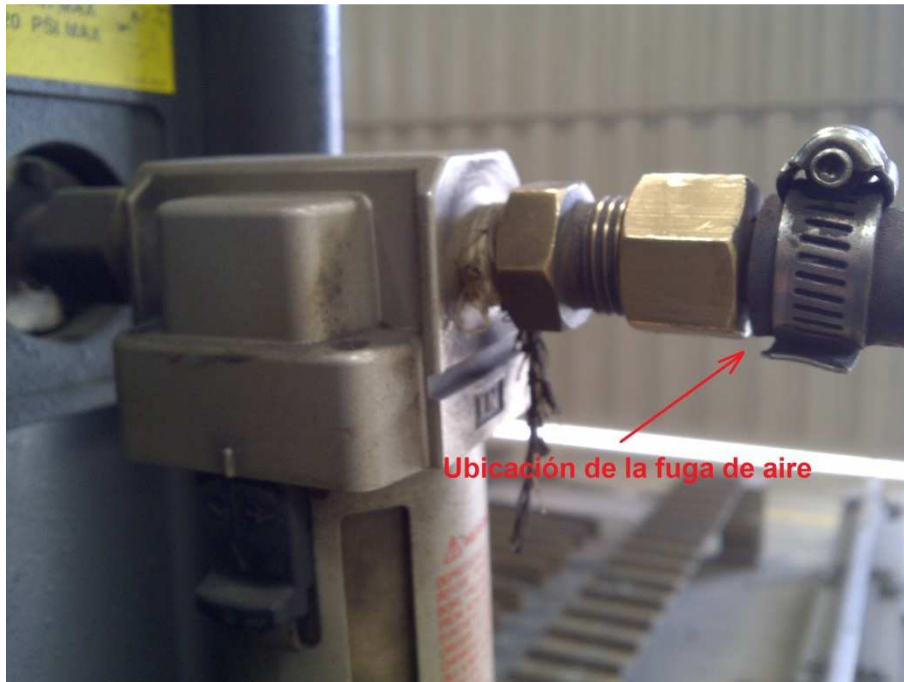
Figura 4.6 Ubicación de la fuga de aire
