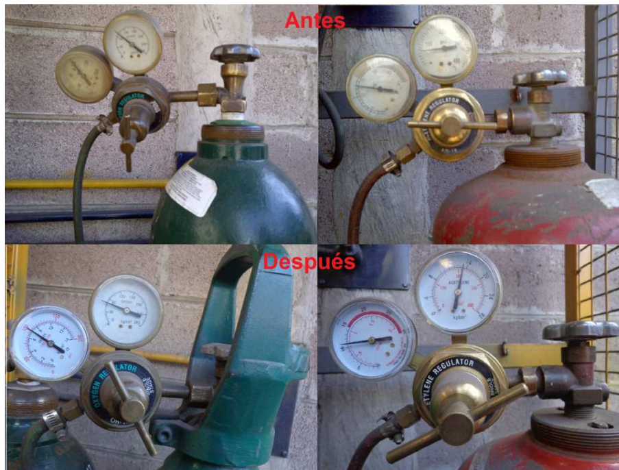
Figura 4.15 Manómetros antes y después de las acciones correctivas
