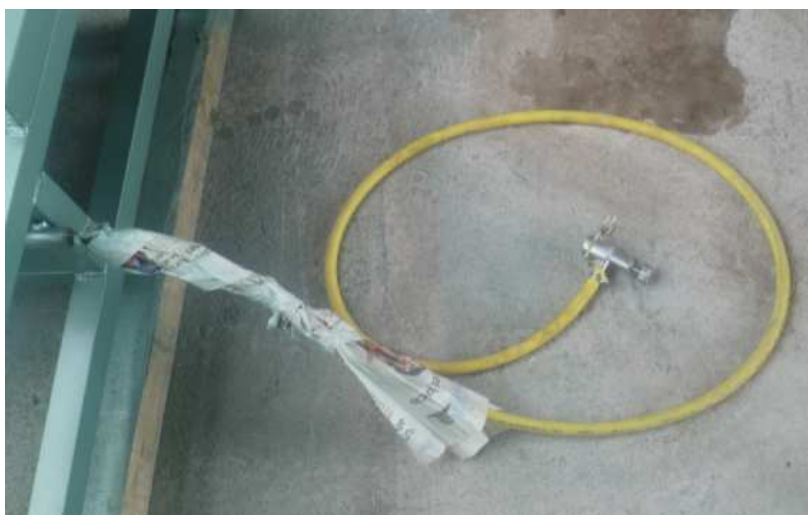
Figura 3.5 Manguera perteneciente al sistema de calentamiento la cual se conecta al tanque de gas para generar la llama
