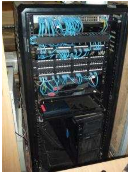
Figura 1.2 Armario de Telecomunicaciones Hacienda Sargazos
